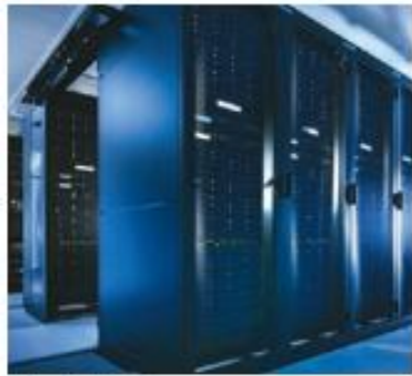
データセンター
