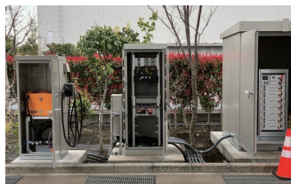
左から直流EV充電器、半導体遮断器、蓄電池
