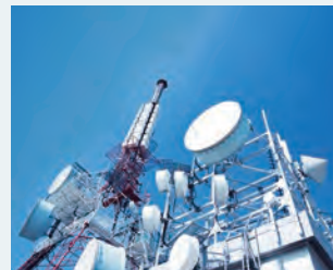
ビル屋上の屋外基地局
