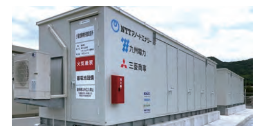
系統用蓄電所
