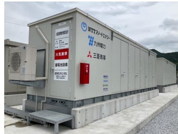
系統用蓄電池 (NTTアノードエナジー社)
