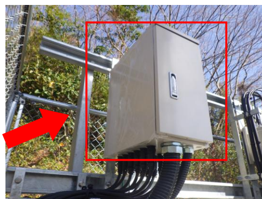
縦置き型分電盤
