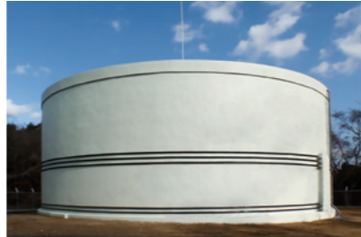
山口県下松市 久保第一配水池 Kubo water tank No.1, Kudamatsu City, Yamaguchi
