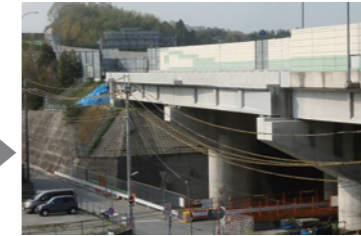
兵庫県神戸市 神戸ジャンクション Cランプ橋 (新設) Ramp Bridge at Kobe Junction C, Kobe City, Hyogo (Newly constructed)
