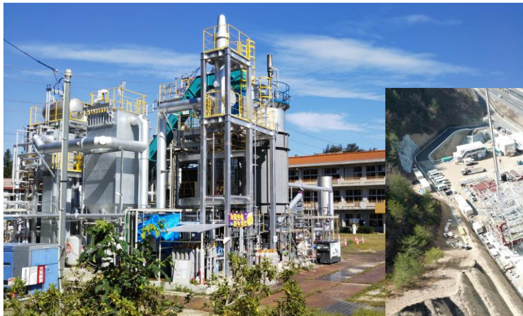
バイオマス発電所（古殿町）
