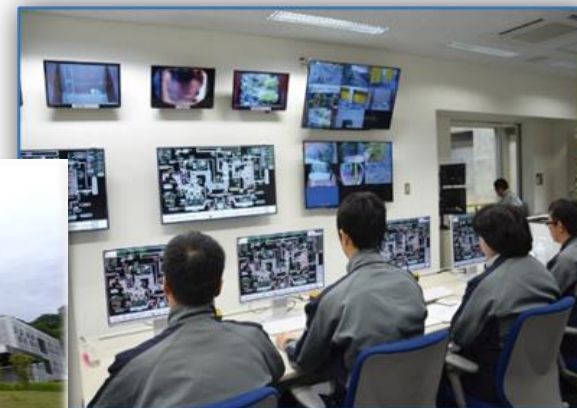
運営・監視設備
