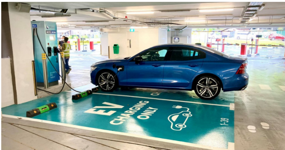
合計 314 サイトに 987 台の EV チャージャーを設置
