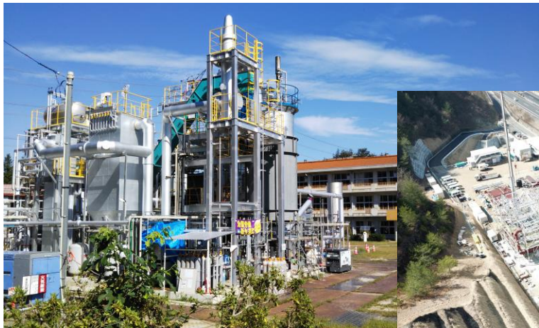
バイオマス発電所（古殿町）
