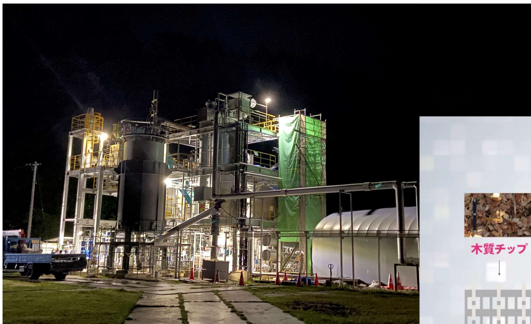
実証実験プラント
