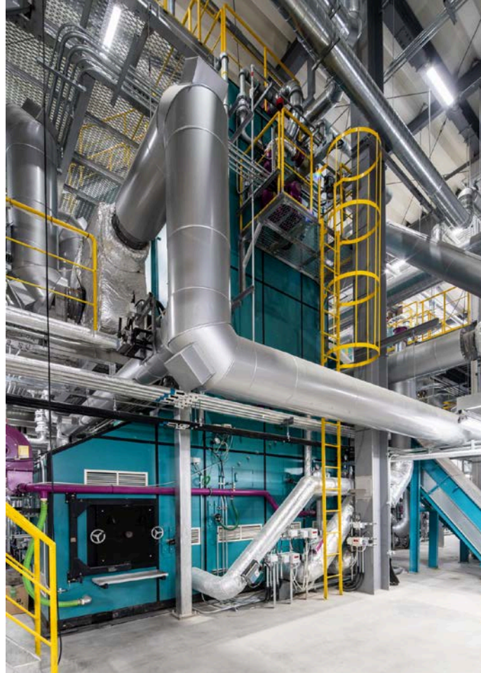
写真は、燃焼炉設備
