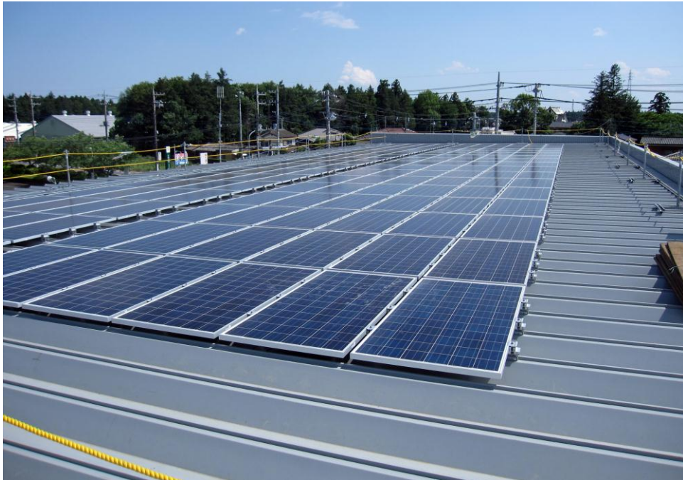
写真は、「エクシオ石岡ソーラーファーム」の 建物(石岡総合技術センター)屋上に設置したソーラーパネル
