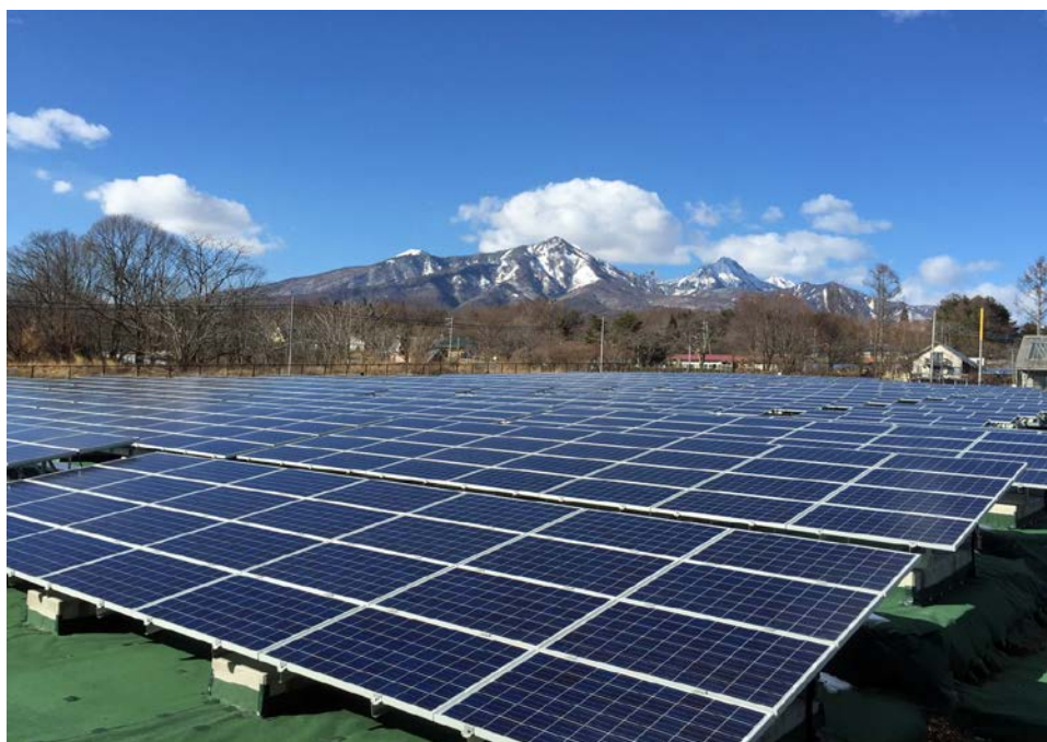
写真は「石堂ソーラー発電所」
