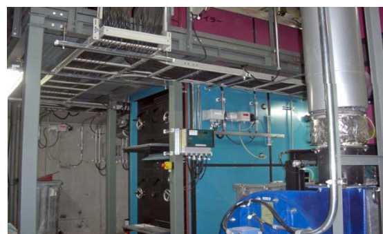
(温浴施設向け木質バイオマスボイラ<山形>)
