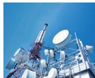
ビル屋上の屋外基地局
