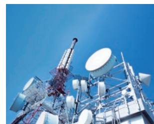
ビル屋上の屋外基地局
