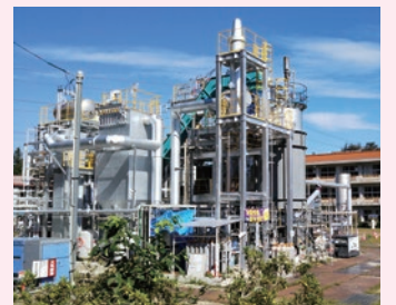
2024年の本格稼働をめざす木質バイオマスガス化発電所(福島県古殿町)
