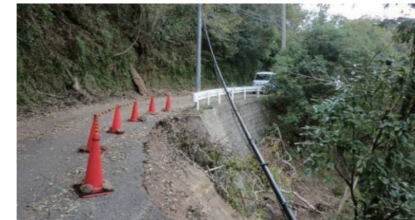
土砂崩れにより電柱倒壊・ケーブル垂れ下がり
