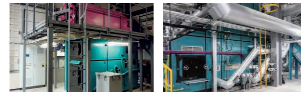
八幡平市バイオマスボイラ
