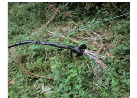
倒木によるケーブル切断
