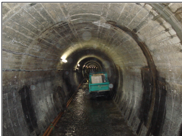
馬蹄形 高さ2.65m 補修前
