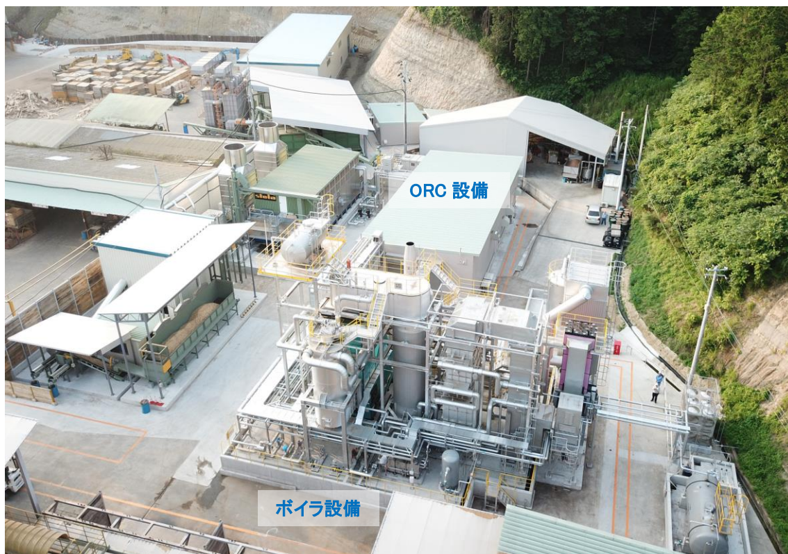
写真は、当社が手掛けた「遠野ウッドペレット工場」のボイラ設備と ORC 設備 (正面手前がボイラ設備で、その上に連結している建物が ORC 設備)
