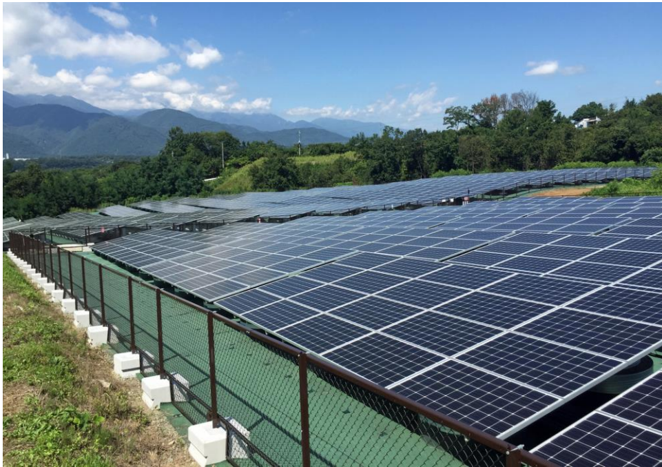
「穂坂ソーラー発電所」
