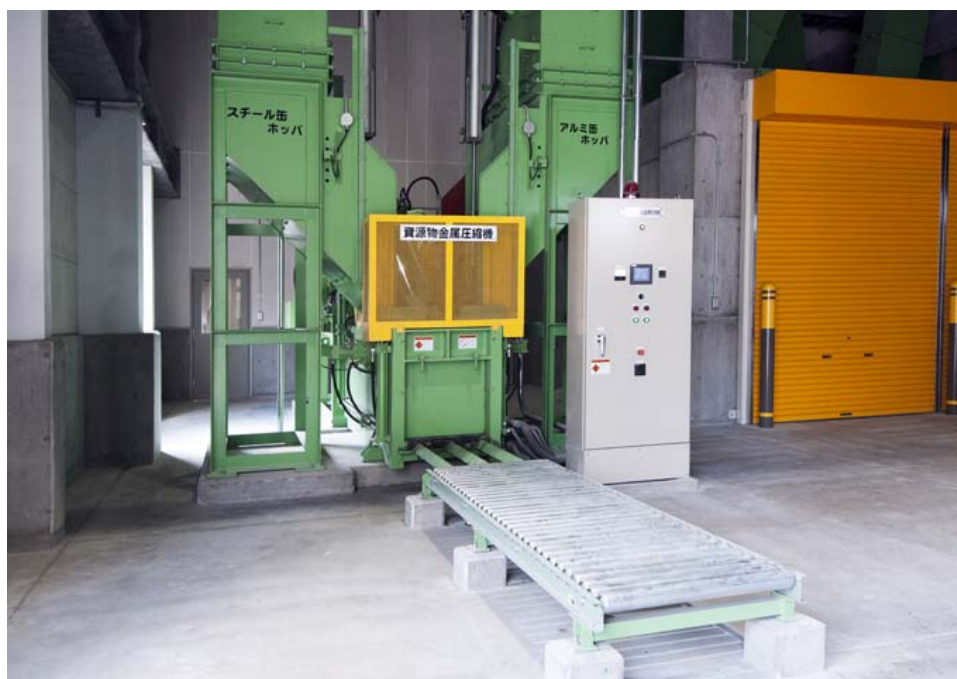
施設内部の様子 (写真は、資源物金属圧縮機)
