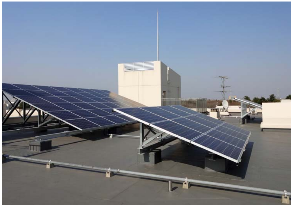
写真は、校舎屋上の3箇所に設置した太陽電池モジュール
