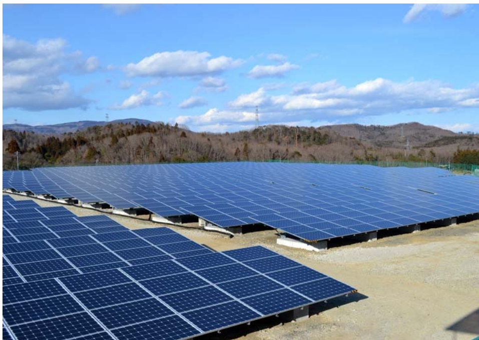
写真は、「エシカル・エネルギー・プロジェクト・いわき 太陽光発電所」
