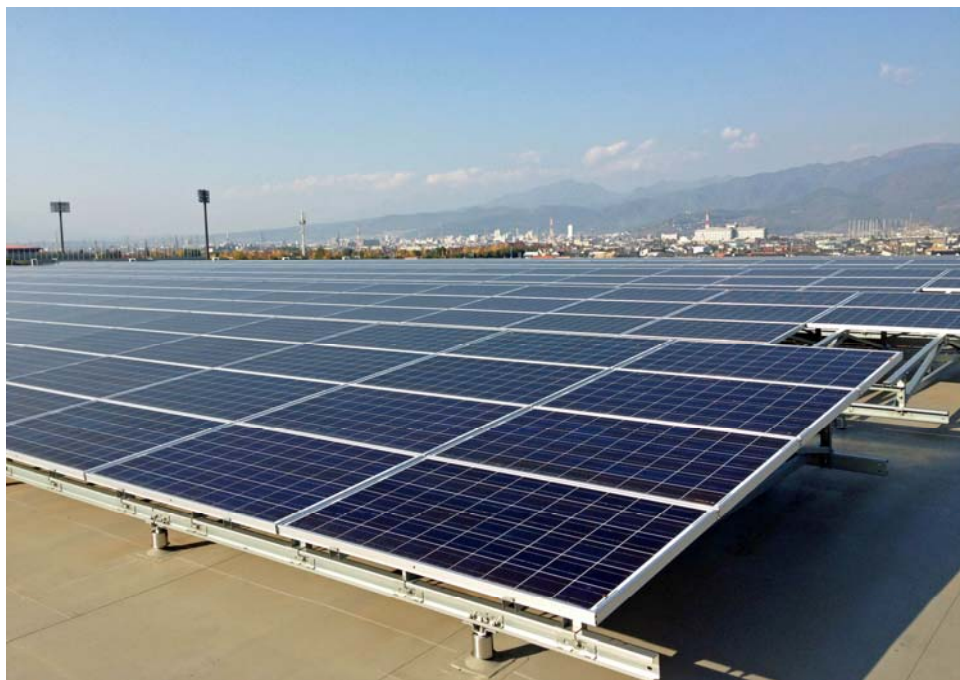
写真は、建物屋上に設置した太陽電池モジュール
