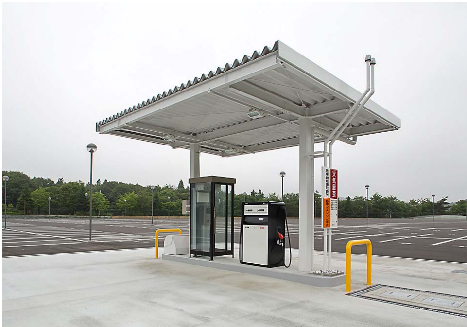
写真は、自家用給油設備
