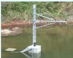
ため池に設置した水位センサー
