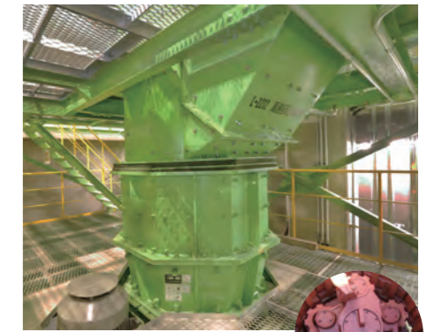
■ 高速回転式破砕機 破砕された不燃ごみをさらに細かく破砕します。
