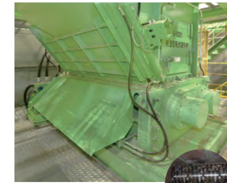
■ 低速回転式破砕機 粗大ゴミコンベヤから供給されたごみを選別しやすいように破砕します。
