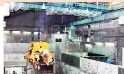
■ごみクレーン
